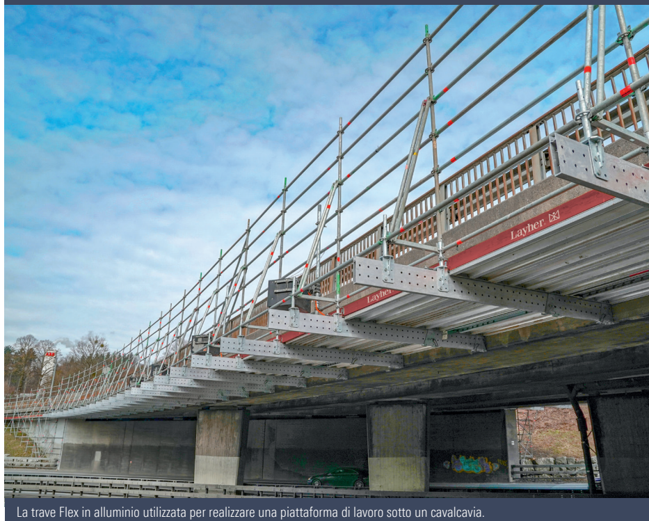
La trave Flex in alluminio utilizzata per realizzare una piattaforma di lavoro sotto un cavalcavia.
